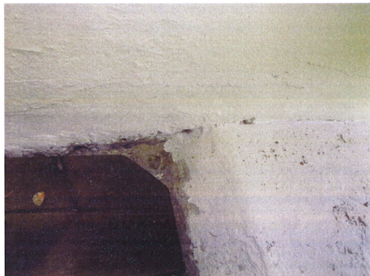
Foto nr. 9: Lok. 4, Dilatasjonsfuge uten sikring.
