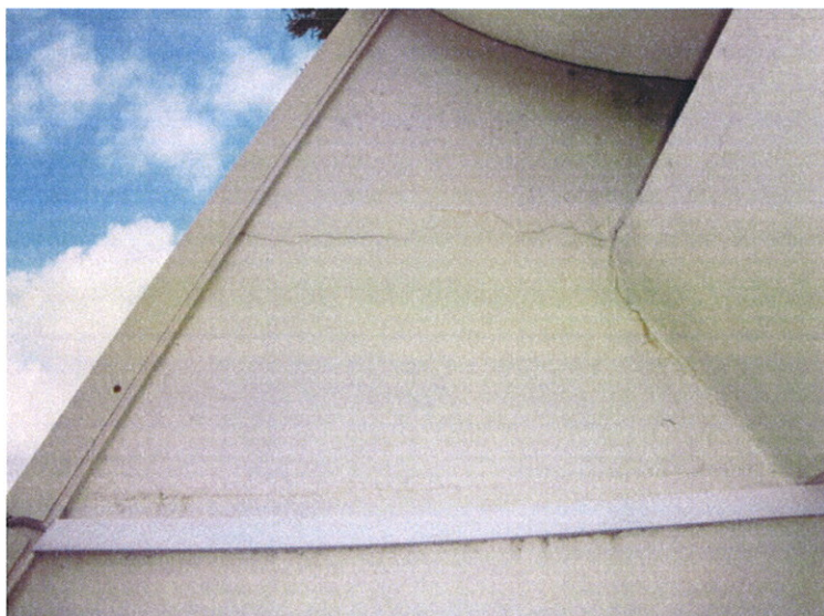
Foto nr. 5: Lok. 2, Typisk riss i skillevegg ut for dekkeforkant.
