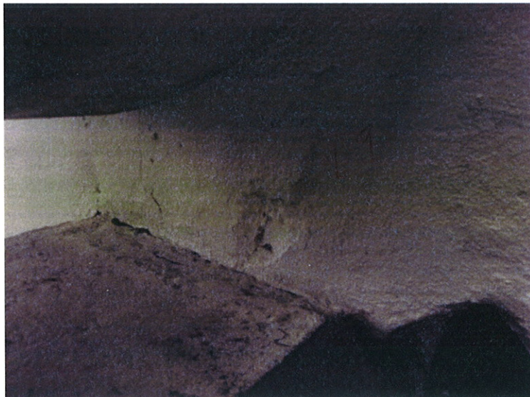
Foto nr 17. Lok 9. Liten synlig skade i skillevegg under blomsterkasse.
