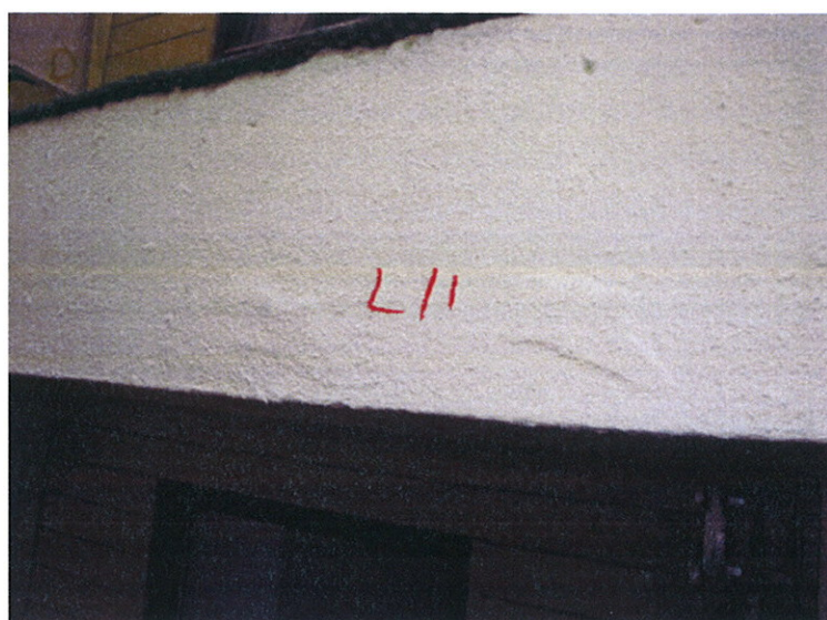
Foto nr 21. Lok 11. Dekkeforkant med avskallinger, trolig over utstikkende armeringsjern.
