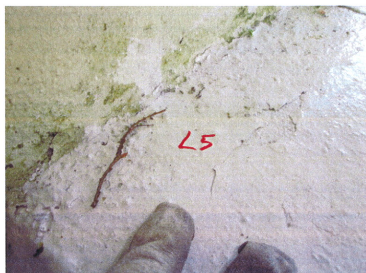
Foto nr 12. Lok 5. Epoxymaling med lokale skader / avflassing.
