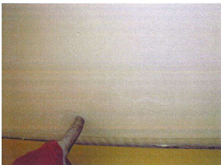
Foto nr. 6: Lok. 2, Skade i tak på terrasseside hvor det er en liten utbuling som indikerer bakenforliggende armeringskorrosjon.
