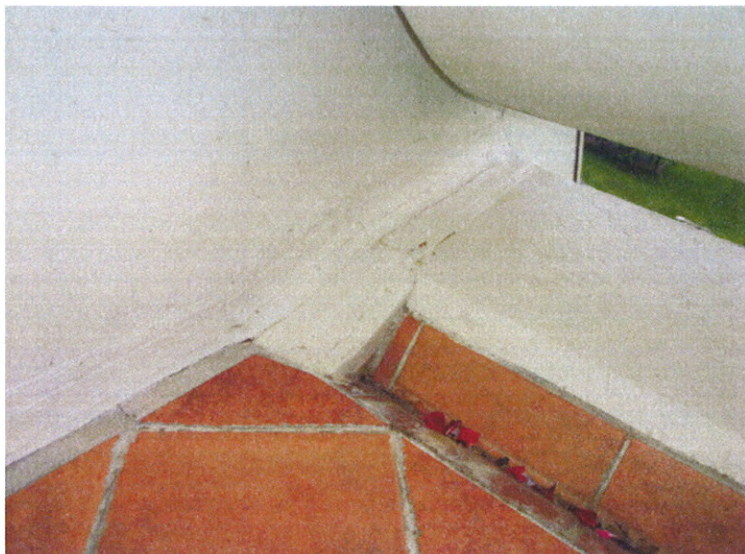
Foto nr. 4: Lok. 2, Ved gulv er det tilsynelatende ikke etablert elastisk dilatasjonsfuge.
