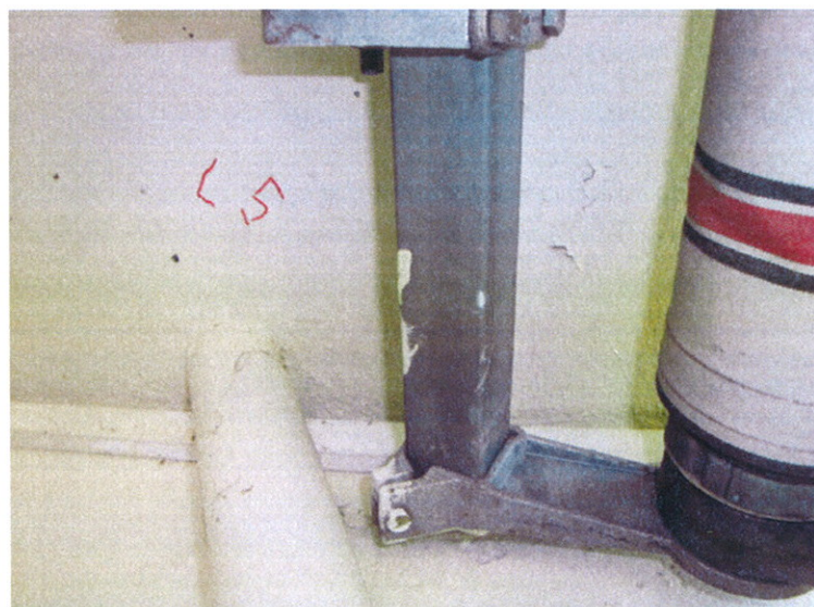
Foto nr 11. Lok 5. Litt malingsavflassing nær nedløpsrør indikerer lekkasje ved slukområde i ovenliggende terrasse.
