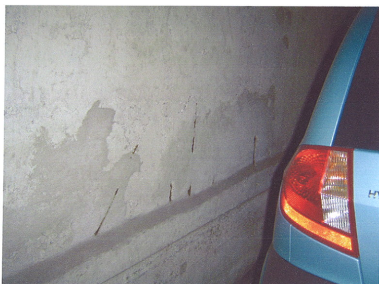
Foto nr. 9: I lok 4, vegg fant vi ikke armering, men viser eksempel på en annen vegg hvor armeringen ligger helt ut i dagen.
