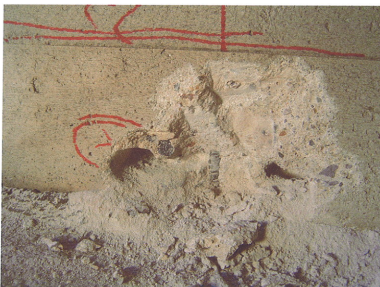
Foto nr. 8: Lok 3. Oppmeisling til vertikaljern viser ren armering.
