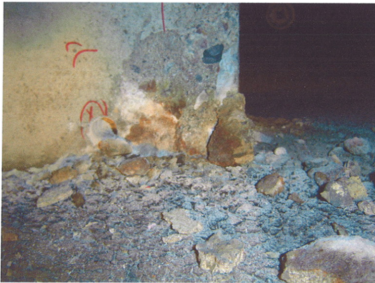
Foto nr. 2: Lokalitet 1, opphugning viser korroderende armering i bunn av søyle selv om ingen synlige skader var å se før opphugging.
