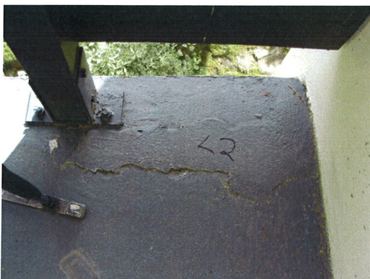
Foto nr. 3: Lok. 2, FB 44, balk, 1 etg. Stor avskalling i balkong gulv.
