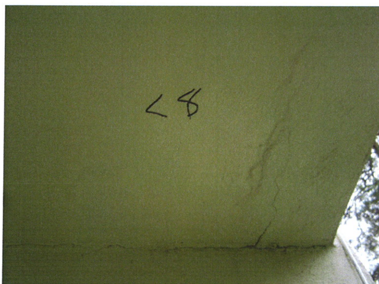
Foto nr 15. Lok 8, FB 24, terr, 1 etg Gammel reparasjon i tak og indikasjon på ny skadeutvikling.
