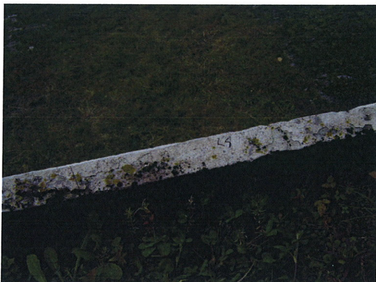
Foto nr 13. Toppen av blomsterkasser er vanligvis "rufsete" som her med avskallet maling, noe frostskaader og mye begroing.
